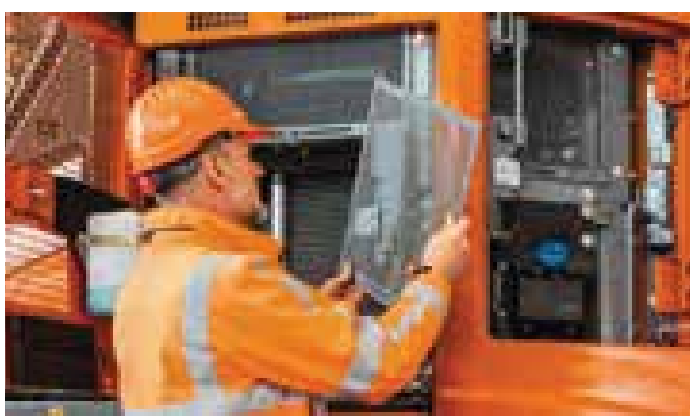
Underhållet utförs enkelt från marknivå.
