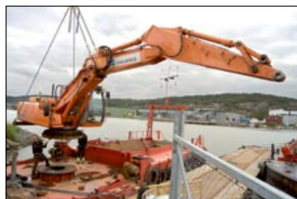
En av Carlbergs äldre EX215 lyfts på plats på ett av företagens mudderverk, där den monteraras och ska sköta muddringsarbetena framöver.
